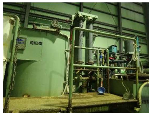
濁水処理設備
