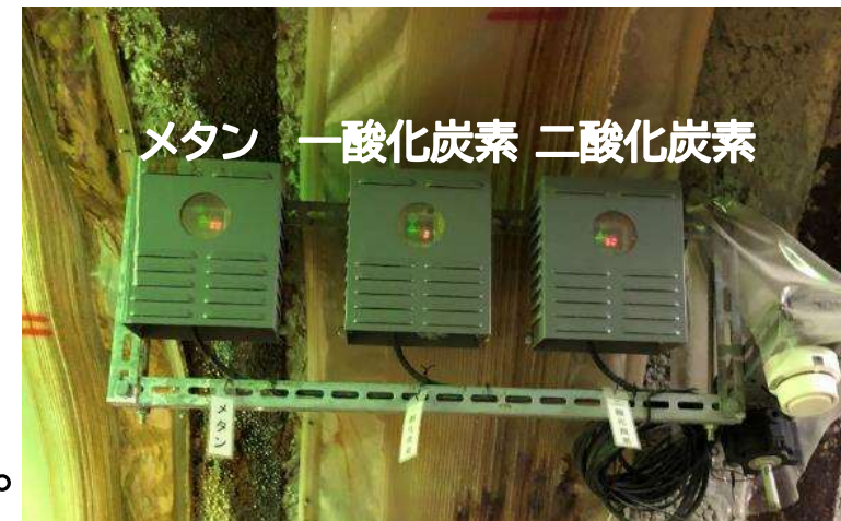
地下の環境を監視するセンサー
