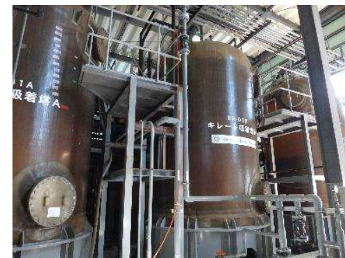
脱ホウ素処理設備
